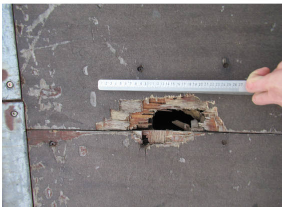
il. 5. Dziury w płytach najazdowych.
