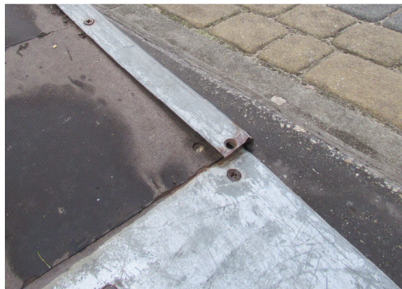
il. 4. Brak mocowań, odstające listwy metalowe.
