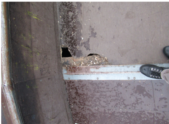
il. 3. Korozja elementów metalowych.
