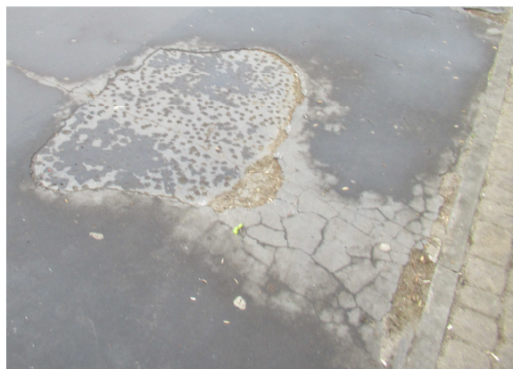
il. 6. Uszkodzona nawierzchnia betonowa.
