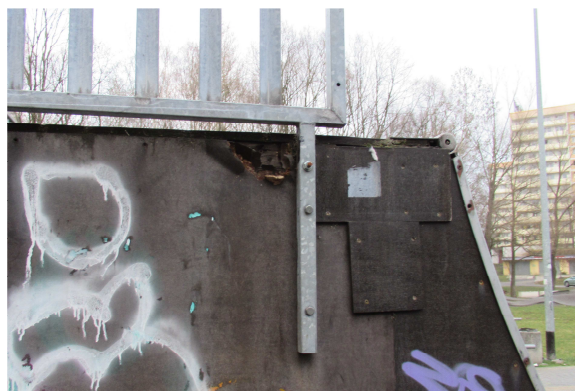
il. 8. Uszkodzenia płyt bocznych.
